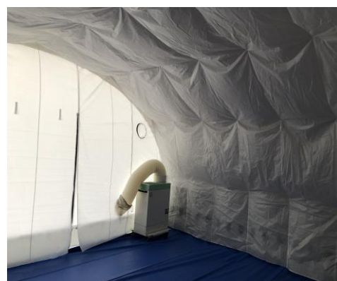
陰圧「エアロシェルター」の内観
