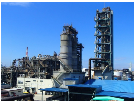
BPAプラント（三井化学 大阪工場）
